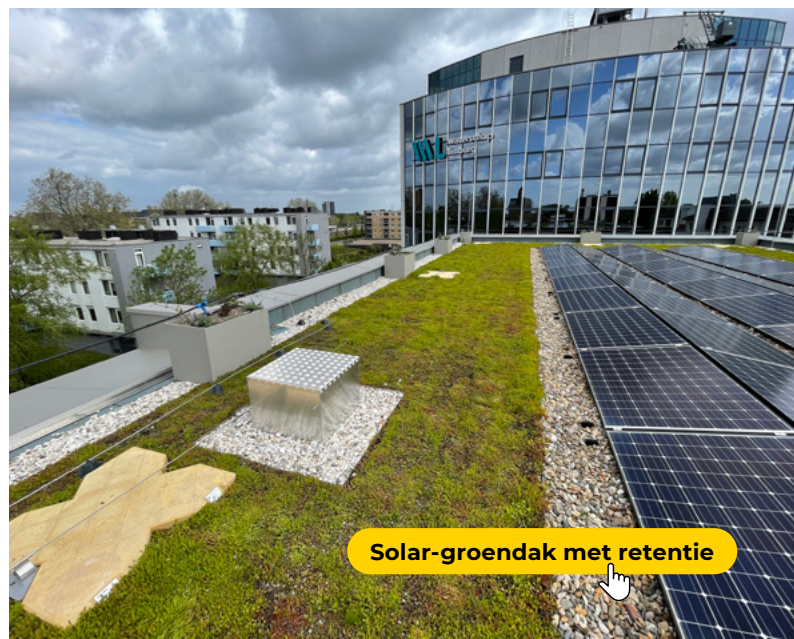
Solardak losliggend geballast
